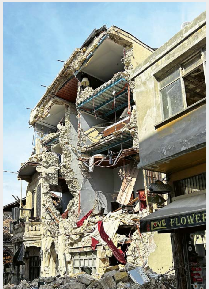
Die Erdbeben können zu Teil- oder TotalEinstürzen führen. Das Foto entstand nach dem Erdbeben in der Türkei, 2023.
