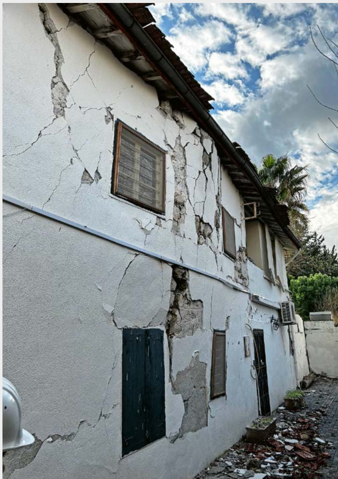
Erdbeben schädigen die Gebäude und Infrastrukturbauten grundsätzlich. Hier das Beispiel des Erdbebens in der Türkei, 2023.
